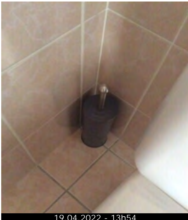
Photo 32 (WC / Accessoires + divers / Brosse WC)
