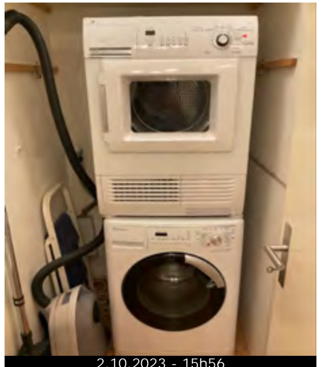
Photo 42 (Réduit / Appareils électriques / Lave-linge)
