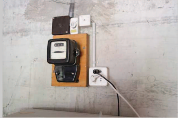
Photo 26: compteur électrique (box)
