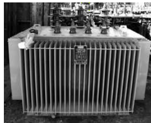
LES TRANSFORMATEURS (FABRIQUÉS AVANT 1986)
