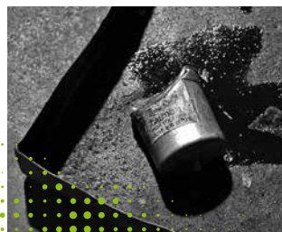
ENDOMMAGEMENT DES CONDENSATEURS
