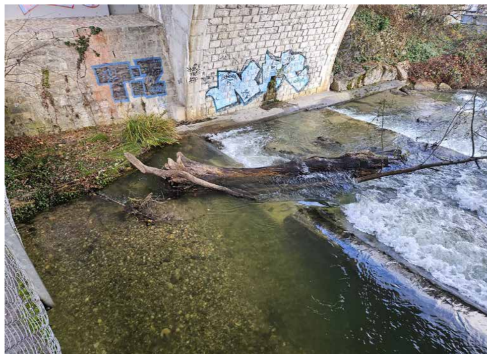
Embâcle obstruant un canal de mesure hydrométrique
