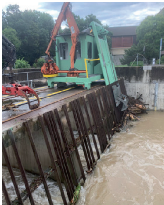
Dégrilleur le lendemain matin
