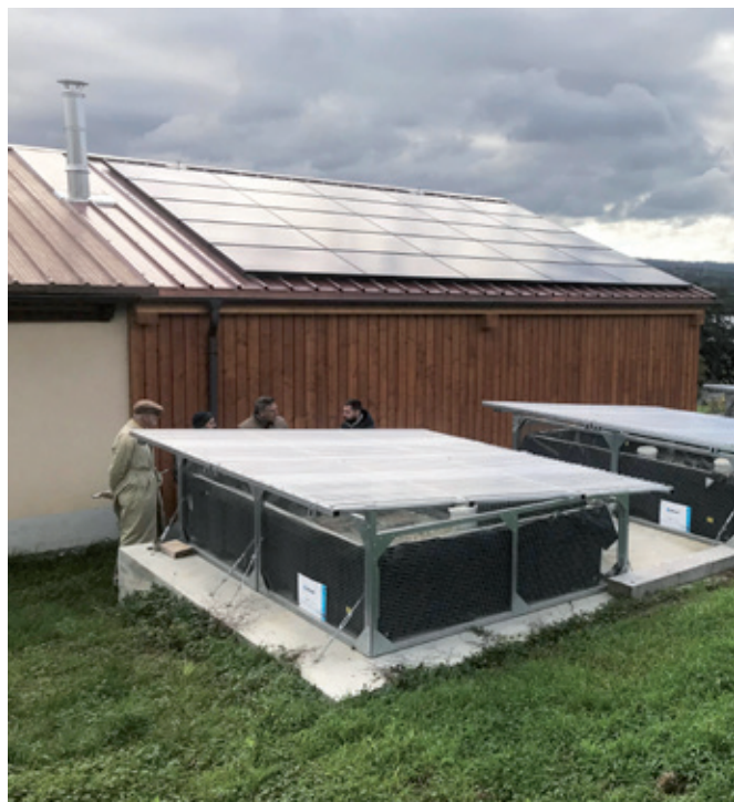
Installation de traitement des restes de produits phytosanitaires à Lully
