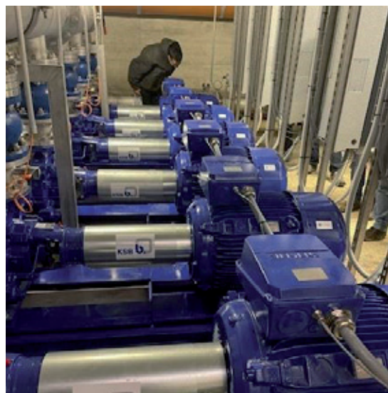
Pompe d'un réseau d'irrigation sur le canton de Fribourg
