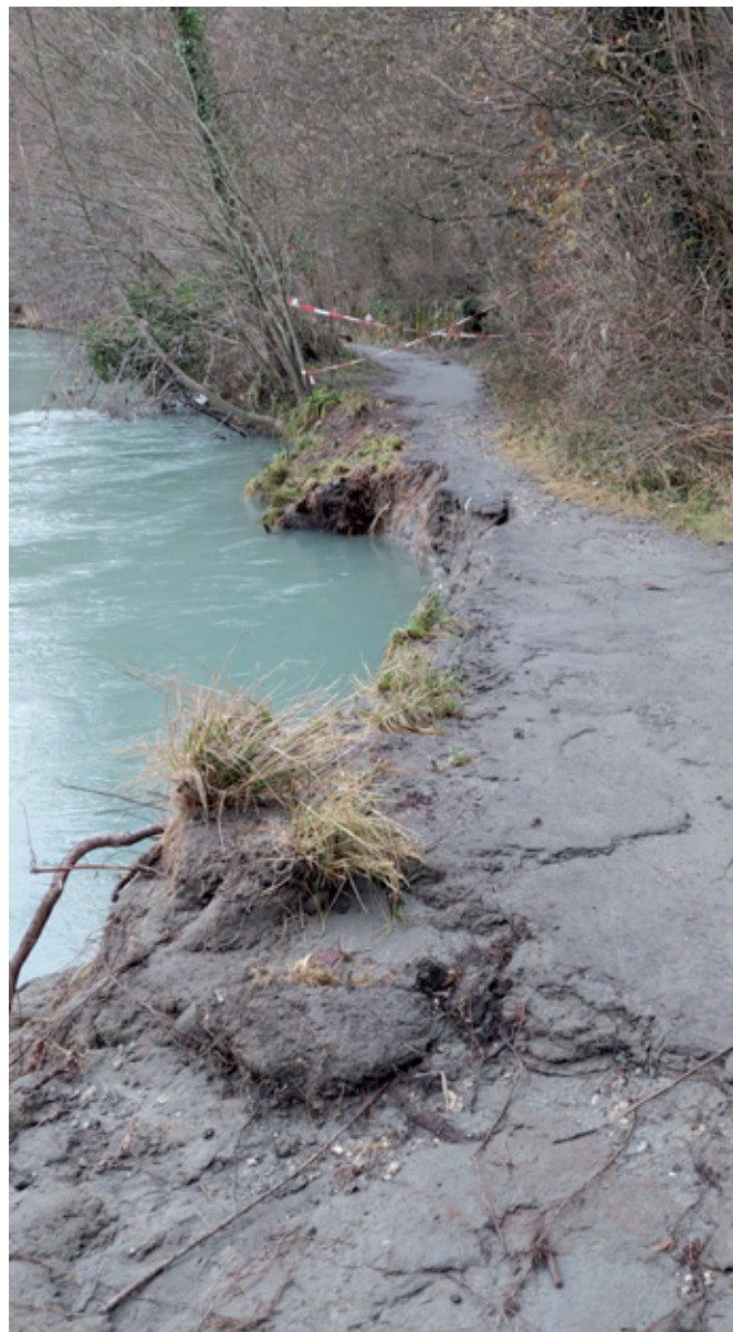
Chemin dangereux après crues
