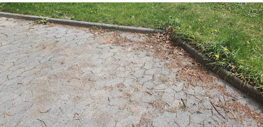
Parking en dalle envahi par les fourmis invasives du genre Tapinoma .
