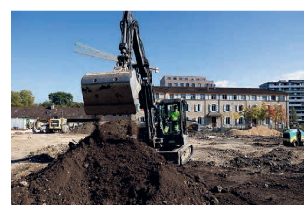
Les sols de ce site, hétérogènes spatialement, ont été décapés et stockés de manière différenciée lors du chantier, pour en extraire les fractions polluées non valorisables à éliminer en décharges, permettant ainsi de valoriser tous les matériaux terreux qualitatifs dans les aménagements extérieurs (butte végétalisée, fosses d'arbres, etc.). * Jacques Apothéloz, 2025
