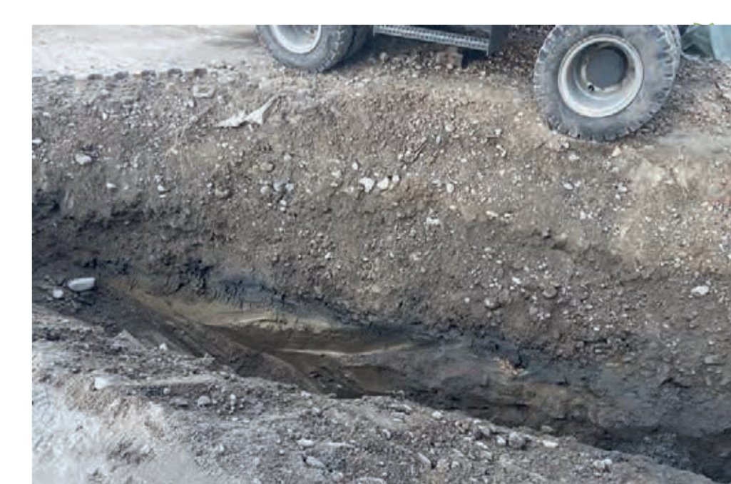
Terrain du parc composé de couches de sol présentant des degrés de pollution différents, à séparer avec précision lors des excavations : - 270 m 3 de terres fortement polluées en décharge type E - 230 m 3 de terres et remblais non pollués excédentaires en décharge type A - 950 m 3 de démolition de béton et enrobés bitumineux - 1000 m 3 de terres et matériaux réemployés sur site après tri des pollutions
