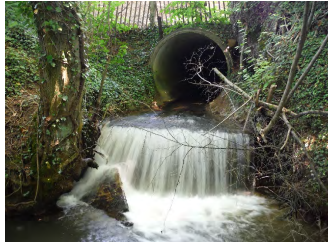
Plus en amont, plusieurs obstacles sont également pénalisants et la chute en aval de la gare de Céligny est totalement infranchissable.
