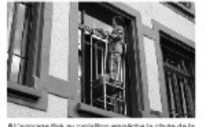
6 L'ancrage fixé au croisillon empêche la chute de la nacelle et de la personne qui se trouve à l'intérieur.
