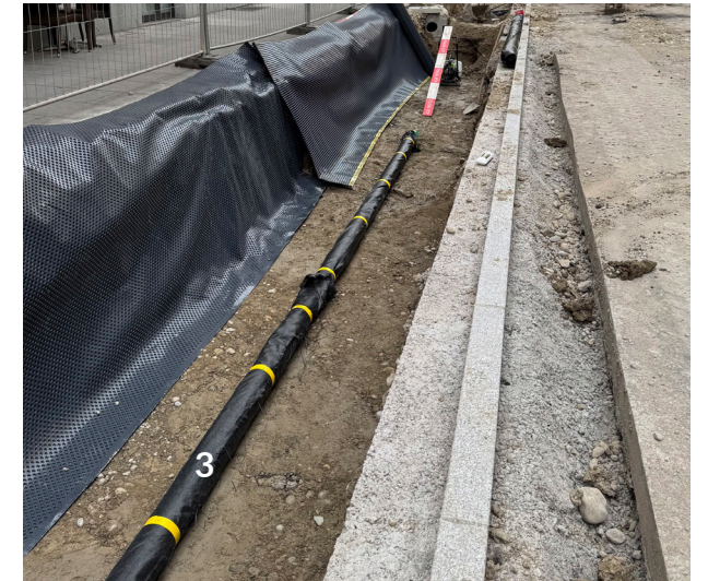
Drain de fond de fosse (-120cm)
