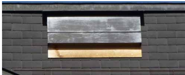
Nichoir « plat » multi compartiment installé sur le toit de l'arsenal cantonal, rue de l'Ecole de médecine, à Genève.
