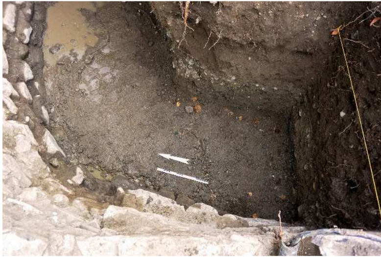
Figure 7 Fondation débordante et légèrement désaxée par rapport à l'orientation du mur (côté bourg).
