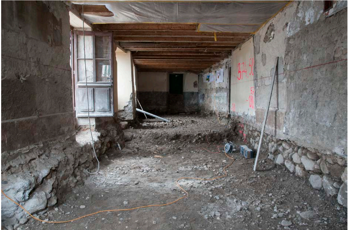
Figure 16. Le mur de façade M4 (à gauche) présente un désaxement très net et une maçonnerie plus épaisse dans sa moitié nord M3 (au fond).
