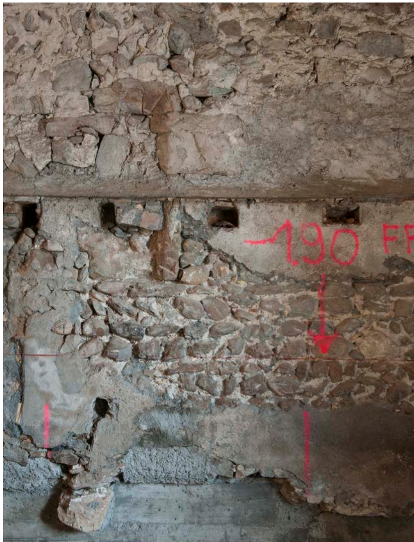
Figure 9. Mur mitoyen. Maçonnerie de pierres de rivière disposées de biais en lits réguliers et alternés.
