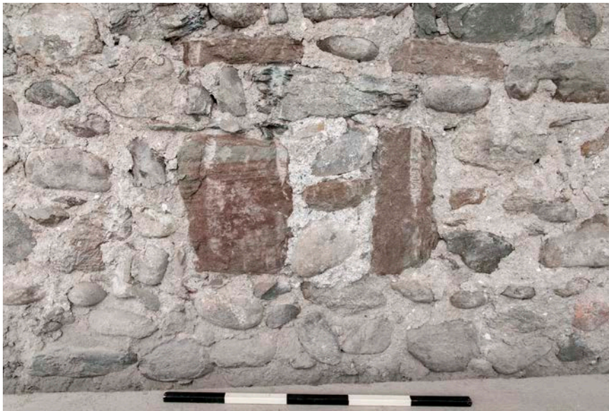
Figure 20. Petite ouverture condamnée (fig. 23 A). Montants en molasse. Le mortier du bouchon se distingue du mortier gris du mur.
