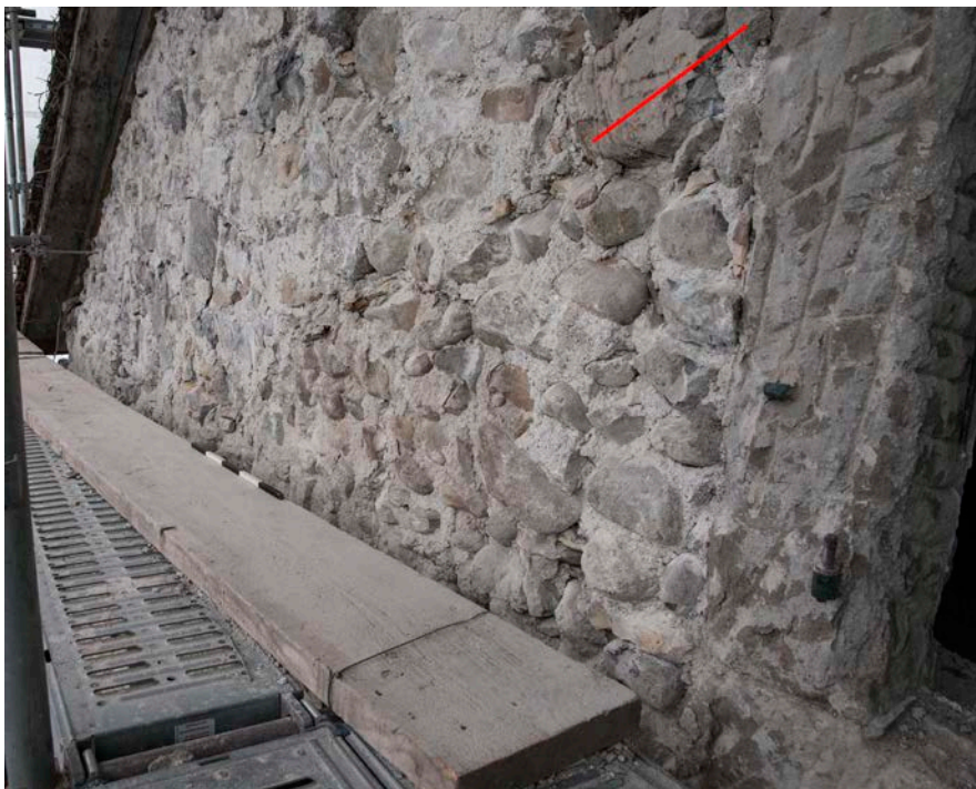
Figure 21. Pente du pignon d'origine (fig. 23 E) visible dans le prolongement du trait rouge.
