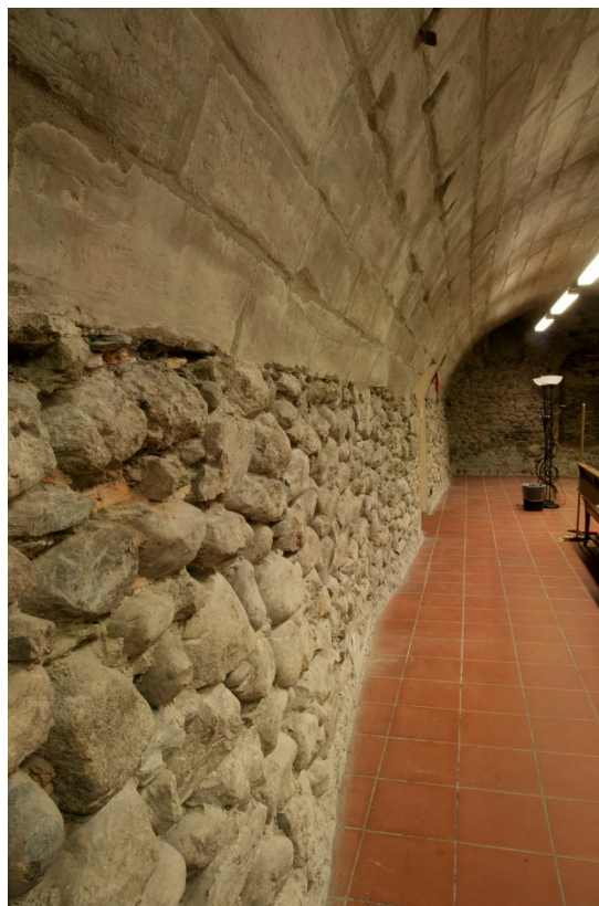
Figure 31. Mur M12 vu en direction de l'est. On remarque le fort désaxement de la maçonnerie US 19.
