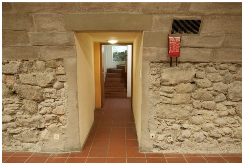
Figure 30. Mur M 12. Vue sur la porte B 37 et le couloir d'accès créé en 1989-1990.
