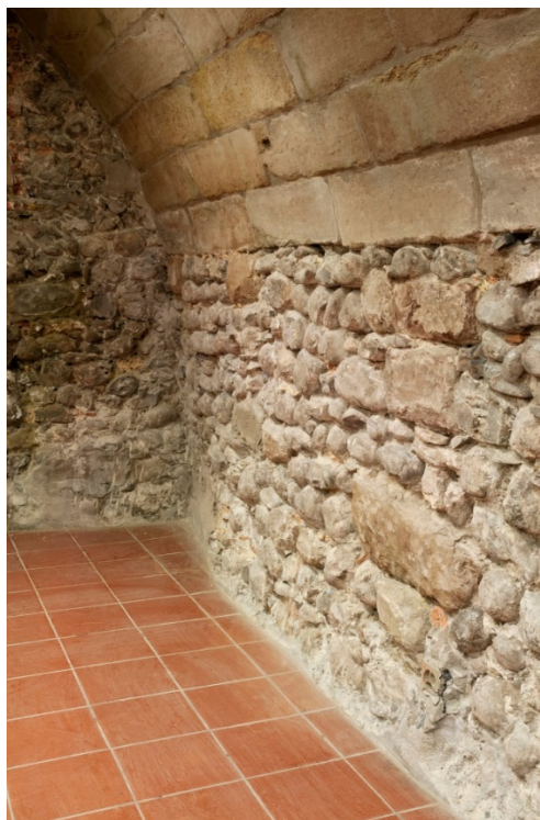
Figure 23. Mur M 11, un changement marqué d'orientation est observé près de l'angle avec le mur M 1.
