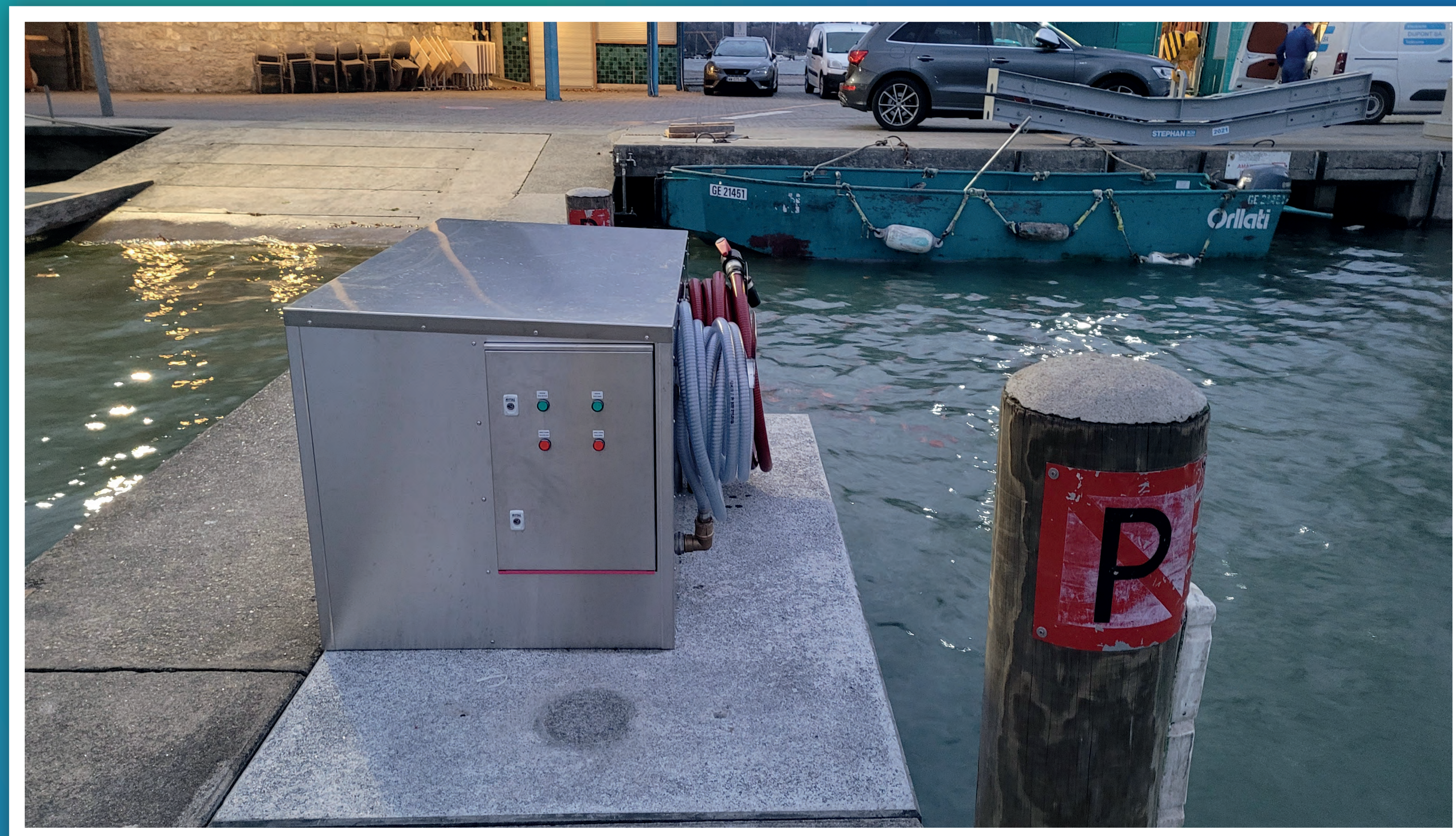
Pompe d'eaux usées et de fond de cale © Etat de Genève
