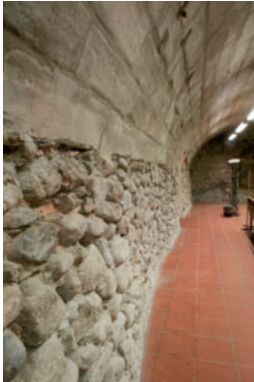
17 Mur nord M 12 vu en direction de l'est. On remarque le fort désaxement de la maçonnerie US 19.
