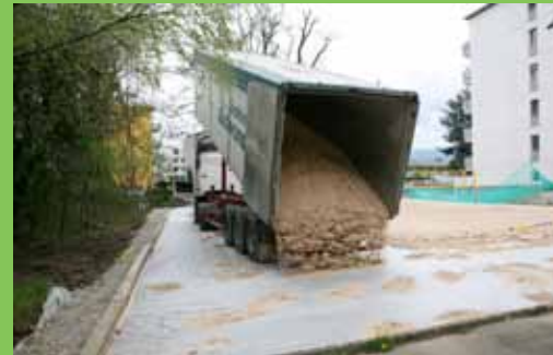
Le terrain a été terrassé avec l'appui de la Ville de Vernier, qui a donné plusieurs coups de main pour soutenir l'association.
