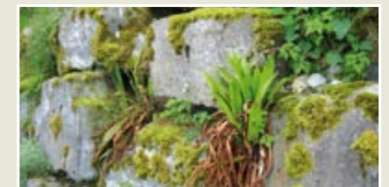
Des zones de rocaille Ballasts CFF abandonnés, vieux murs, façades de bâtiments de type falaise.
