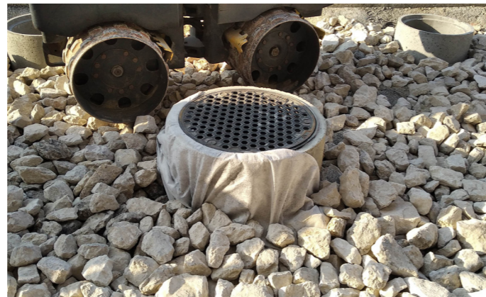
16. Regard de diffusion. La différence de hauteur entre les pierres et le couvercle du regard correspond à l'épaisseur de terre végétale à venir
