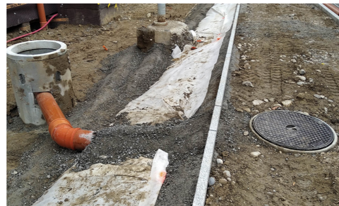
4. A droite, le sac gouflre récupérant les eaux de la chaussée. A gauche, le regard de diffusion (N°1) dans la fosse.
