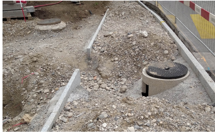
1. Sac gouflre déporté + encassement du trottoir
