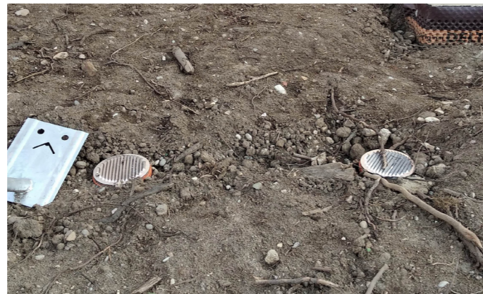
18 Pipes de rinçage des drains en surface
