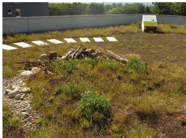
Végétalisation et rétention en toiture
