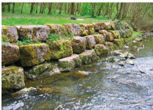
Figure 2 : Enrochements disproportionnés limitant la connectivité latérale (partie amont)
