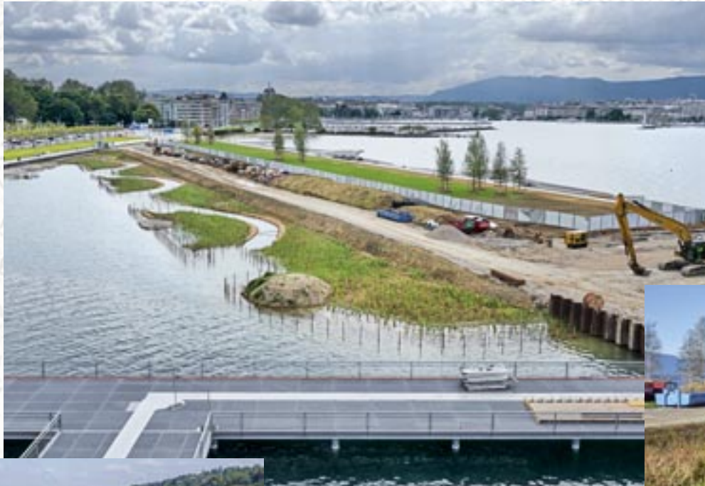
La roselière et son plan d'eau à la fin des travaux de plantation, 2019
