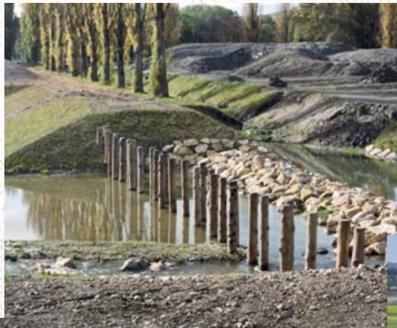
Le peigne bloque les corps flottants lors des crues, 2013
