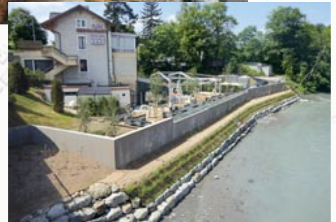
Aménagements destinés à protéger la parcelle des inondations de l'Arve, 2019
