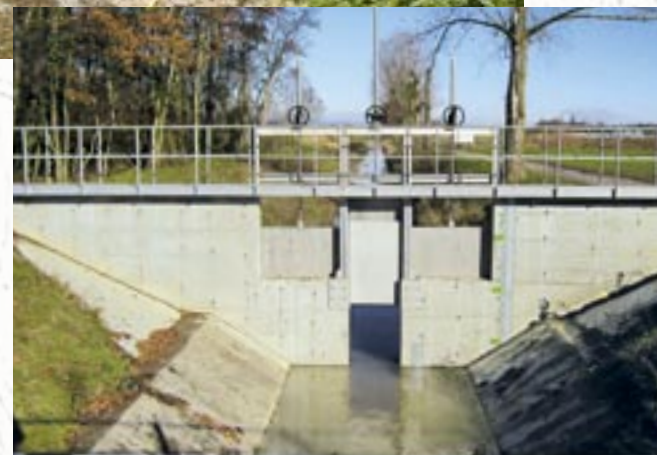
Seymaz, première étape des travaux vanne de régulation des débits au pont de la Motte, 2007
