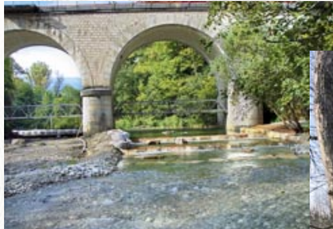
Sous le pont CFF, succession de seuils franchissables pour la faune piscicole, 2015
