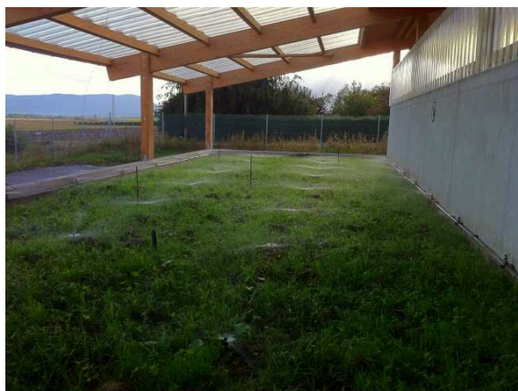
Photo 12: Bioépurateur collectif de Dardagny
