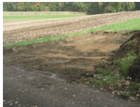
Aire d'installation de chantier préparée en décapant le sol (solution non recommandée).
