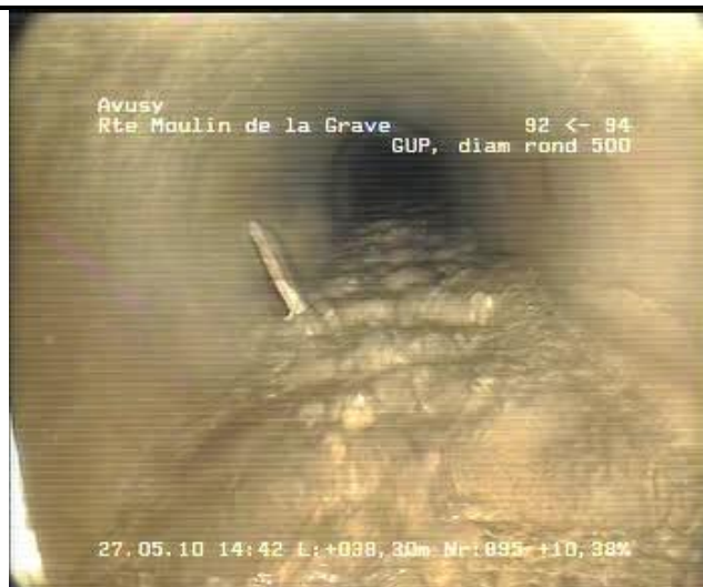
Exemple de section déjà largement réduite du fait des dépôts calcaires
